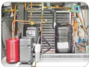
■ 冷凍機房技術 ■
